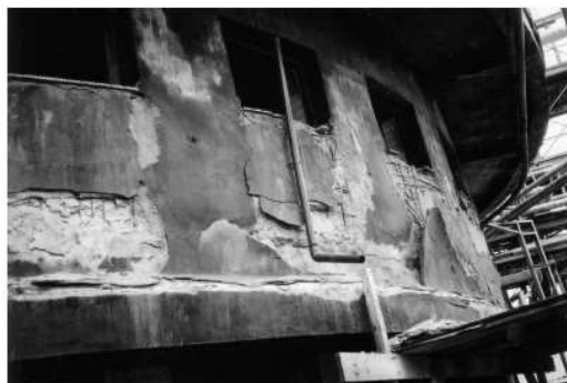
Rys. 3. Uszkodzona dolna monolityczna część powłoki wieży
