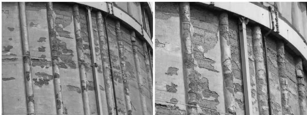
Rys. 8. Dobry stan stalowej konstrukcji wzmocniającej, uszkodzenia korozyjne elementów żelbetowych
