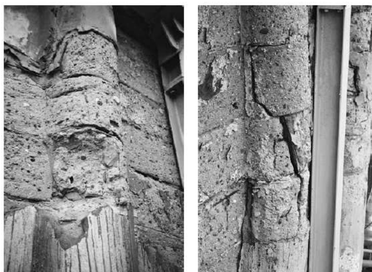
Rys. 9. Uszkodzenia uźebrowania prefabrykowanej powłoki walcowej
