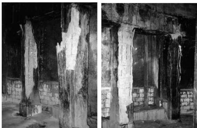
Rys. 4. Rozległe uszkodzenia słupów podbudowy
