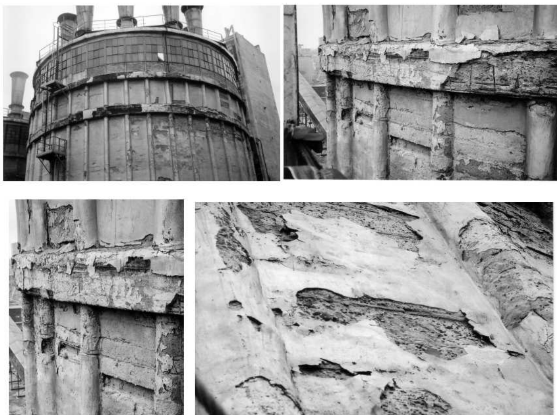
Rys. 2. Charakterystyczne uszkodzenia korozyjne prefabrykowanej części wieży granulacyjnej
