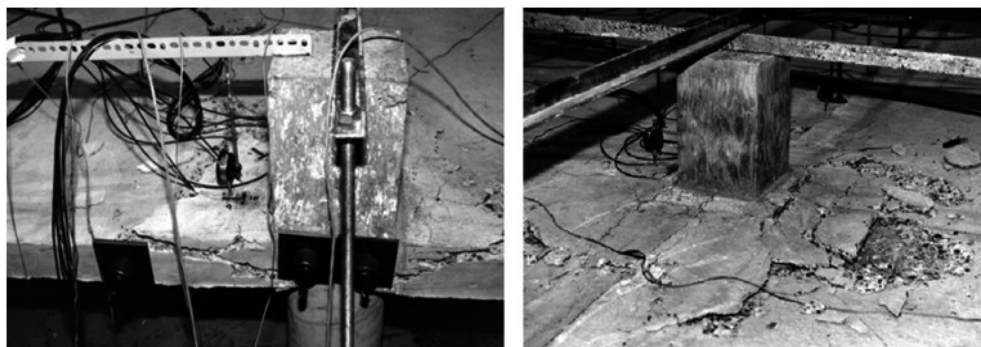
Rys. 11.17. Uszkodzenie przez przebicie płyty nad słupem skrajnym i środkowym [49]
