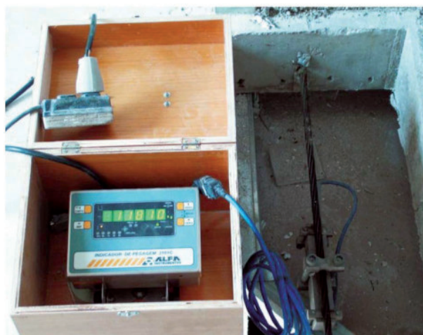
Rys. 11.32. Widok ekstensometru zainstalowanego na płycie sprężającym we wnęce pomiarowej [124]
