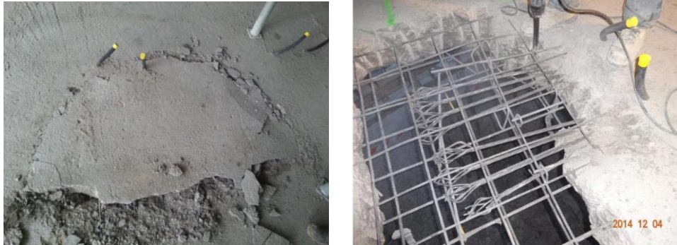
Rys. 78 Rozerwanie strefy zakotwień biernych w płycie.
