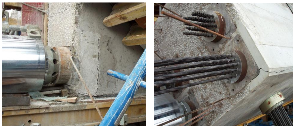
Rys. 75 Uszkodzenie (pęknięcie) strefy zakotwień w skutek jąd przeciążenia.
