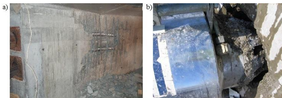
Rys. 76 Uszkodzenie belki w wyniku złego ukształtowania jej geometrii bądź zbrojenia (a), zapadnięcie się zakotwienia przez słabe zagęszczenie betonu (b).
