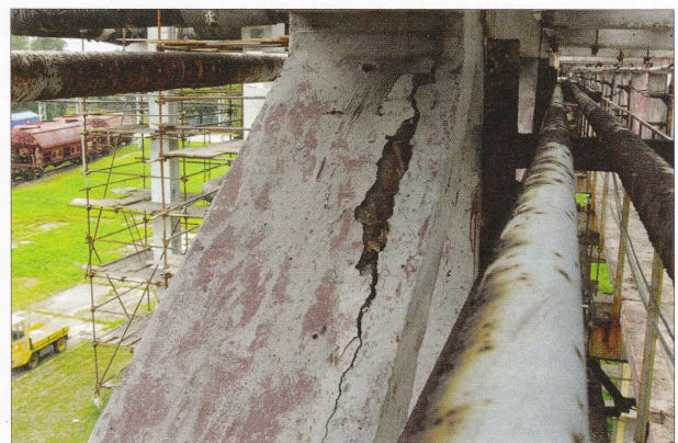
Fot. 6 | Widoczne uszkodzenia krzyżulca i słupka kratownicy
