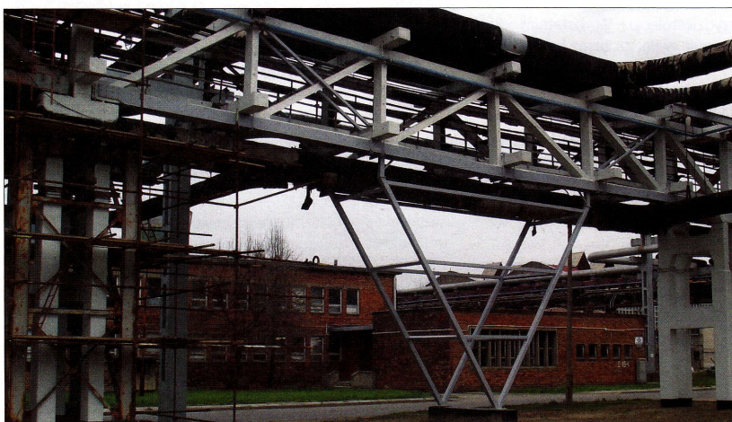
Fot. 7 | Widoczne uszkodzenia krzyżulca i słupka kratownicy
