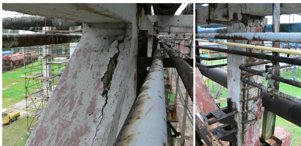
Rys. 8 i 9. Widoczne uszkodzenia krzyżulca i słupka kratownicy
