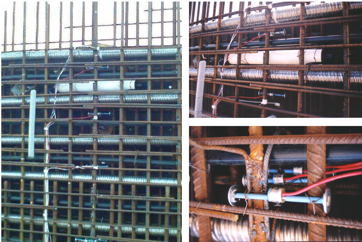
Fot. 5-2 Widok przetworników odkształceń i naprężeń w przekroju przęsłowym (A-A) dolnego segmentu ściany.
