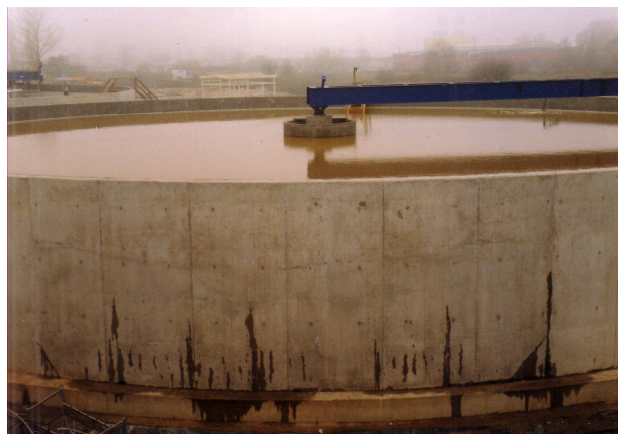
Fot. 1-1 Widok porysowanej od skurczu termicznego i przeciekającej ściany zbiornika utwierdzonej w dnie.
