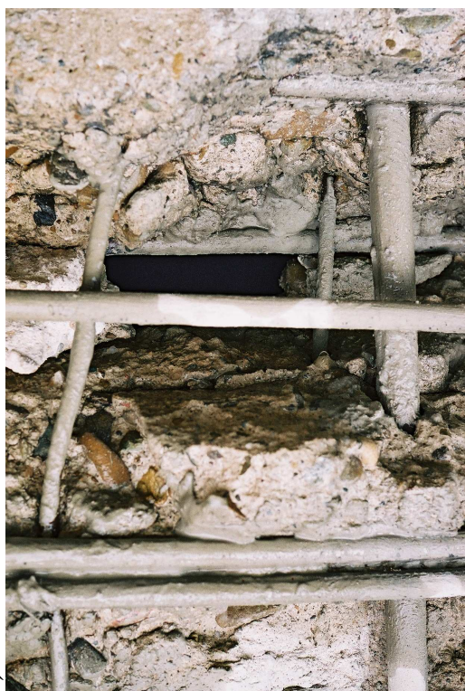
Rys. 2. Ubytki w ścianie silosu nr 6..
